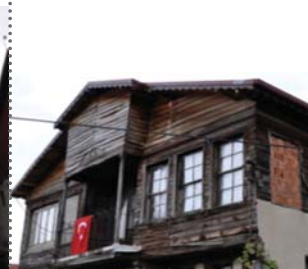
Şekil 13. Duvar Boşluklarında Değişim ve Bozulma Örneği
