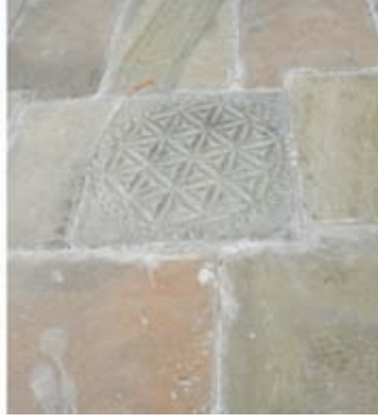
Şekil 18. Kuzey Cephe Duvarında Bulunan Kabartma Motif Örneği, 2016
