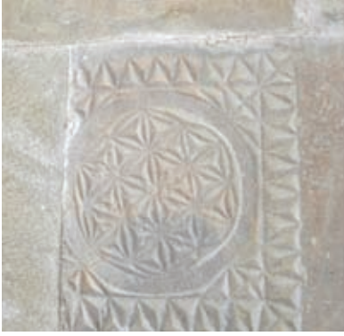
Şekil 17. Kuzey Cephe Duvarında Bulunan Kabartma Motif Örneği, 2016
