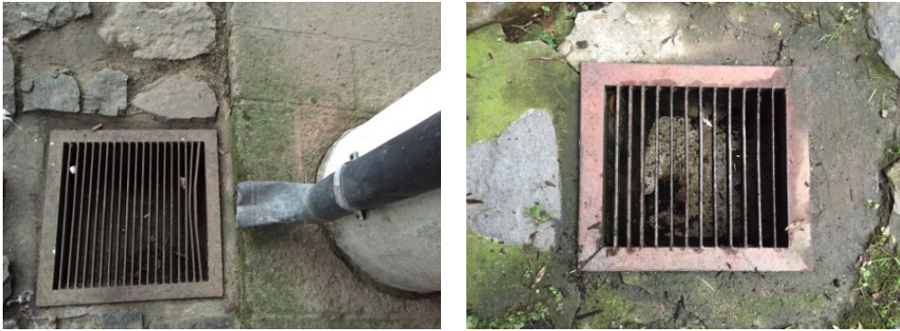
Fotoğraf 21. Izgaralarda Deformasyon ve Tıkanma
