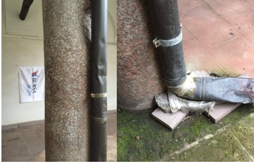
Fotoğraf 20. Su Borularında Görülen Biçimsel Deformasyonlar
