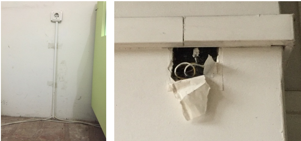
Fotoğraf 22. Açıkta Görülen Elektrik Kabloları
