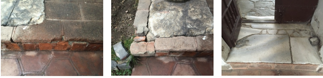
Fotoğraf 12. Döşeme Kaplamalarında Yüzey / Parça Kayıpları ve Aşınma
