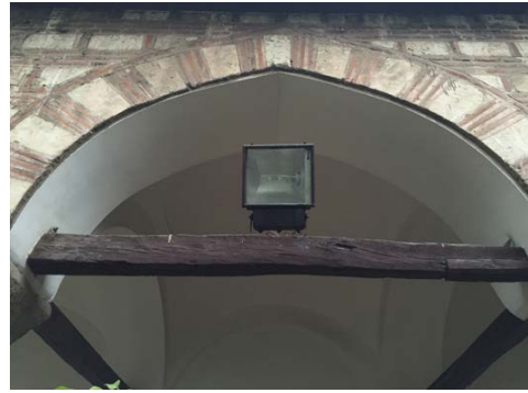
Fotoğraf 25. Ahşap Gergi Kirişlerinde Görülen Sorunlar
