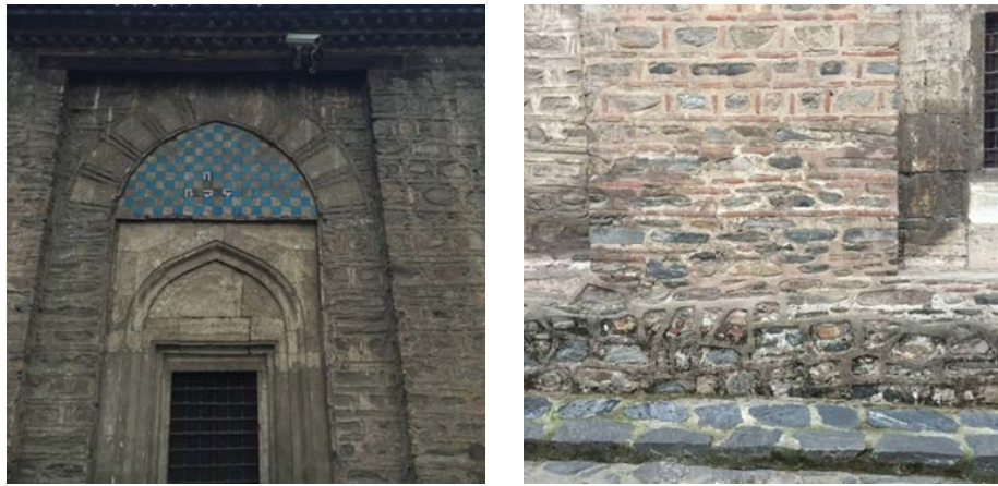
Fotoğraf 7. Duvarlarda Görülen Kirli Yüzey Oluşumundan Örnekler
