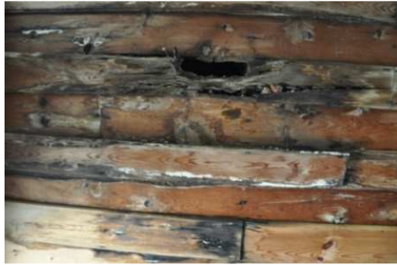
Şekil 21. Mahfil Kotu Ahşap Elemanlarında Bozulmalar
