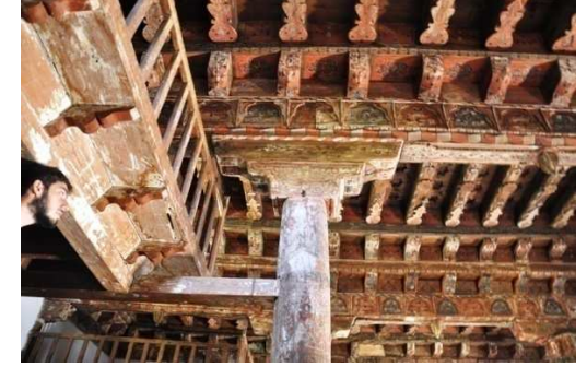
Şekil 13. Ahşap Dikmelerde Bozulma ve Bezeme Kayıpları
