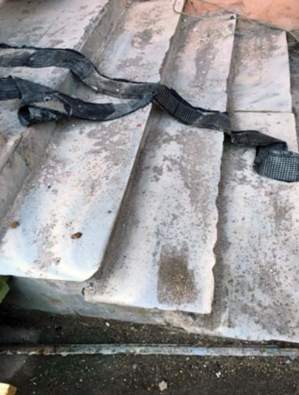
Şekil 19. Giriş Merdiveninde Görülen Bozulmalar
