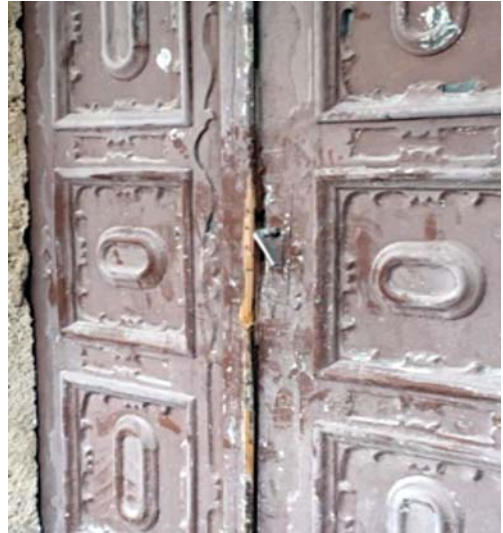
Şekil 21. Ahşap Dış Kapıda Çeşitli Bozulmalar
