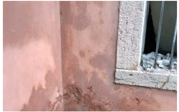
Şekil 11. Dış Duvar Yüzeyinde Nemlenme
