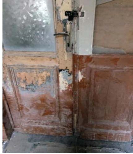
Şekil 23. Ahşap Kapılarda Kullanıma Bağlı Yıpranma
