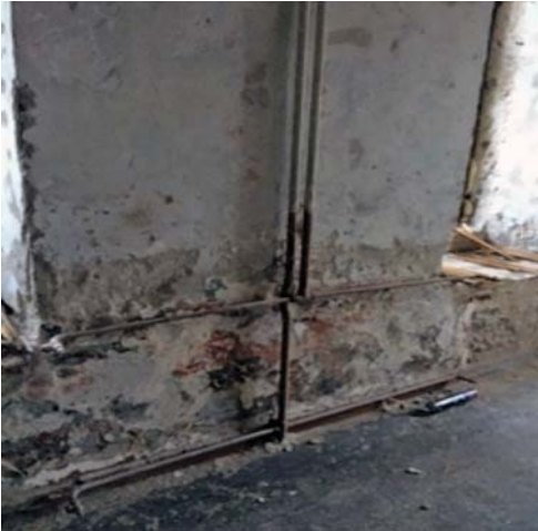
Şekil 15. İç Duvar Zemin Seviyesinde Nemlenme
