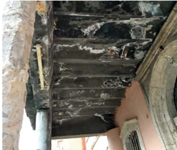
Şekil 17. Çıkma Döşemesinde Çiçeklenme
