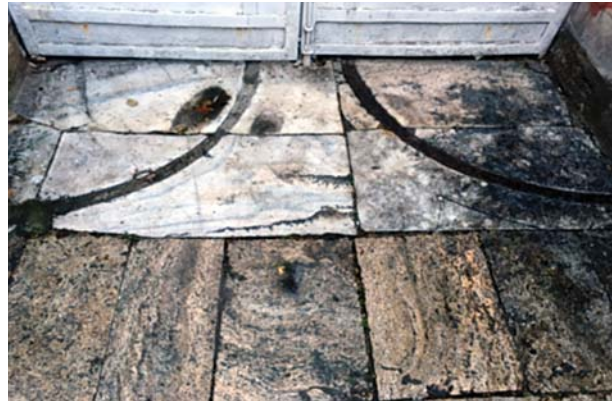
Şekil 16. Zemin Kat Taş Döşemesinde Bozulmalar
