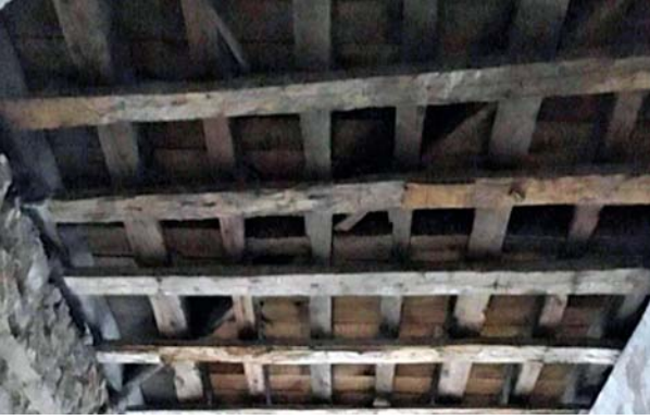
Şekil 18. Ahşap Döşeme Elemanlarında Bozulmalar
