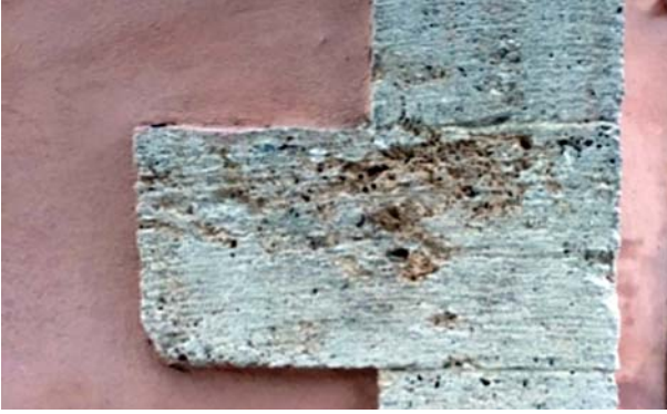
Şekil 13. Taş Sövede Yüzey Kaybı
