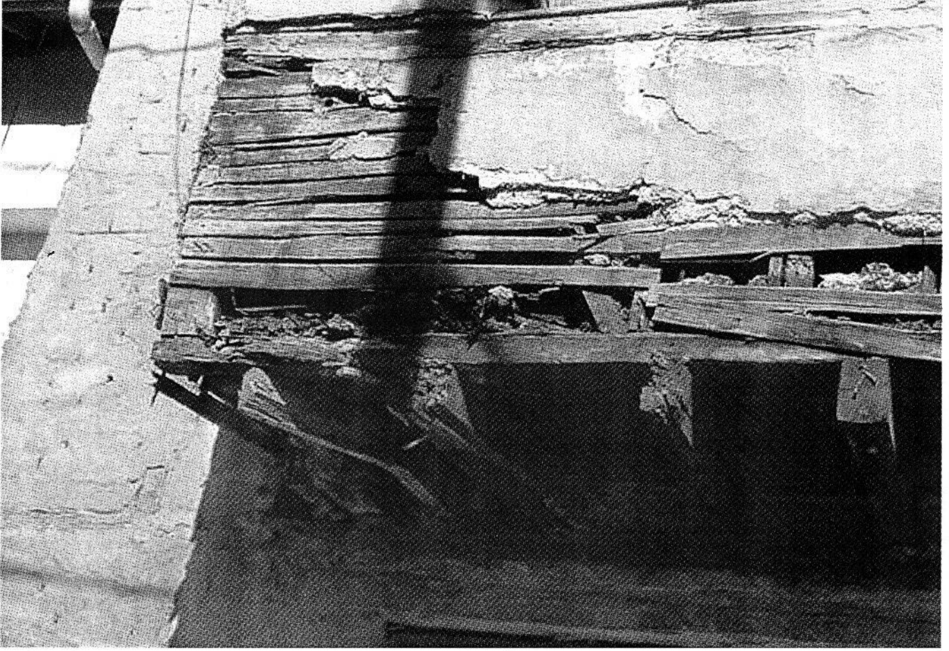
Resim 7 Diğer ahşap ürünlerde görülen bozulmalara Demirkapı Mahallesi geleneksel konutlarından bir örnek.
