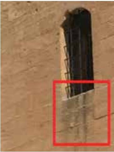
Şekil 22. Korozyona Bağlı Pas Lekesi
