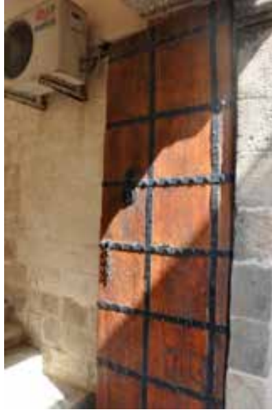
Şekil 37. Ahşap Kapı Kanadında Aşınma ve Renk Değişimi, Metal Elemanda Korozyon
