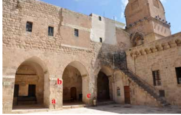
Şekil 10. Ulucami'nin Tek Taşıyıcılarında Görülen Malzeme Sorunları
