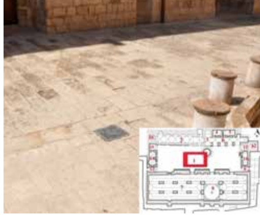
Şekil 31. Düz Döşemede Görülen Aşınma
