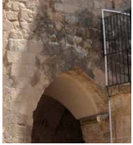
Şekil 38. Kemerde Kabuk Oluşumu ve Renk Değişimi
