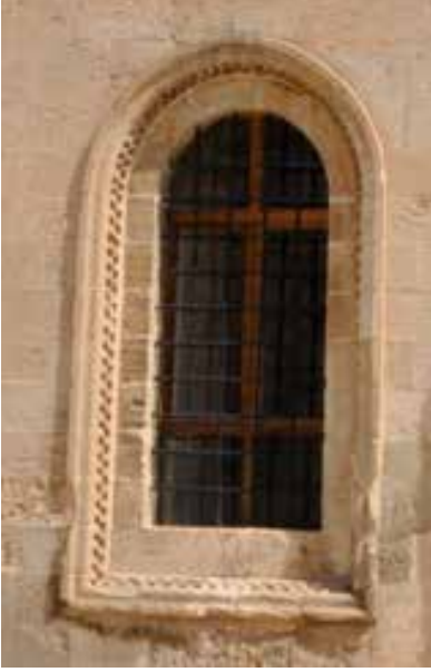
Şekil 36. Pencere Sövesinde Parça Kopması
