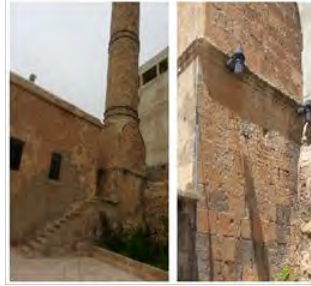
Şekil 4. Minarede Parça Kopması
