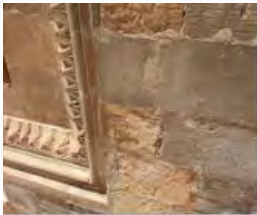
Şekil 3. Duvarda Yüzey Kaybı
