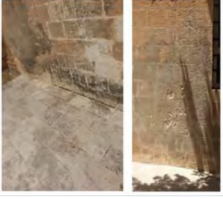
Şekil 6. Duvarda Oyuklu Yüzey Oluşumu
