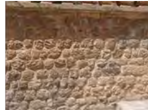
Şekil 5. Duvarda Boşluk - Delik Oluşumu
